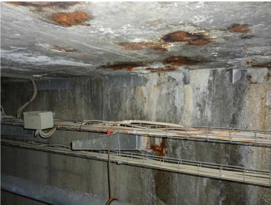
Billede 2. Kraftige rustudfældninger på underside af promenadedækket stammende fra chloridinitieret korrosion (hurtig nedbrydning).
