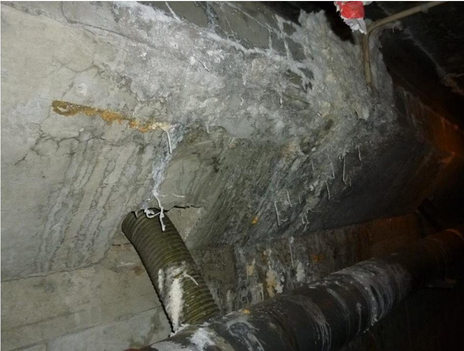
Billede 3. Konsol til svømmebassin med mange revner med gennesisvninger og udfældninger.
