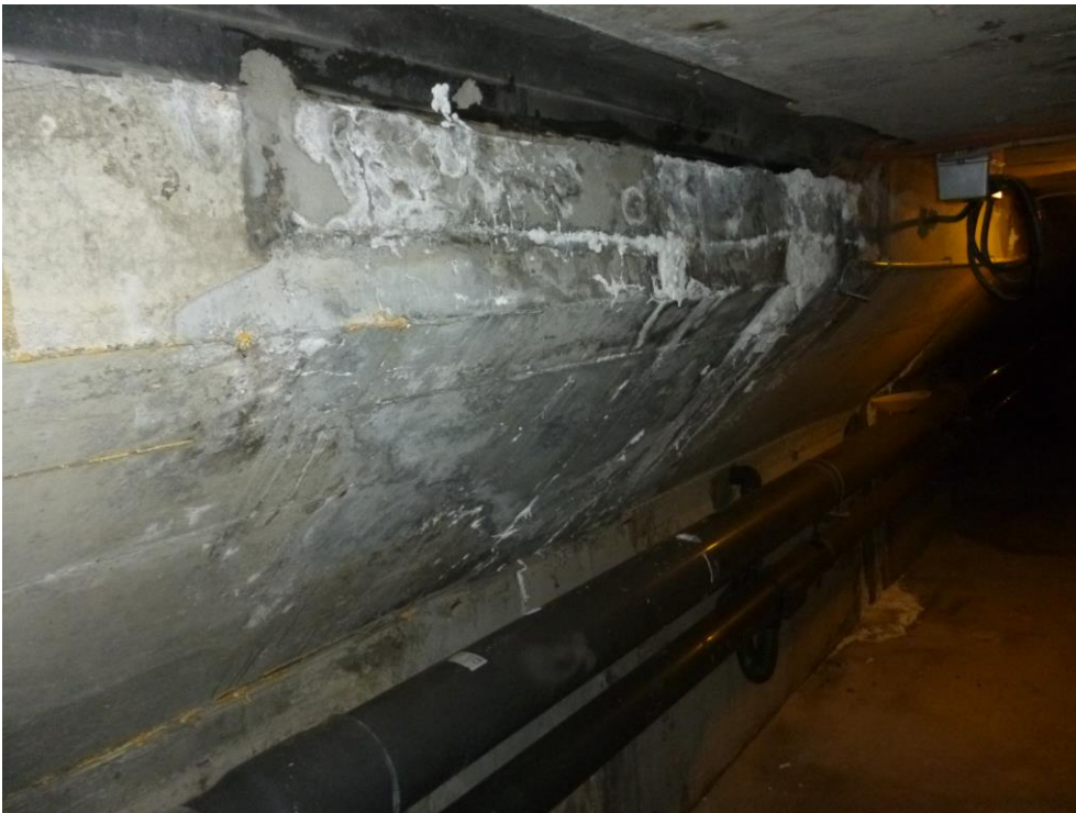
Billede 6. Bassinkonsol med revner, gennemsivninger og udfældninger.
