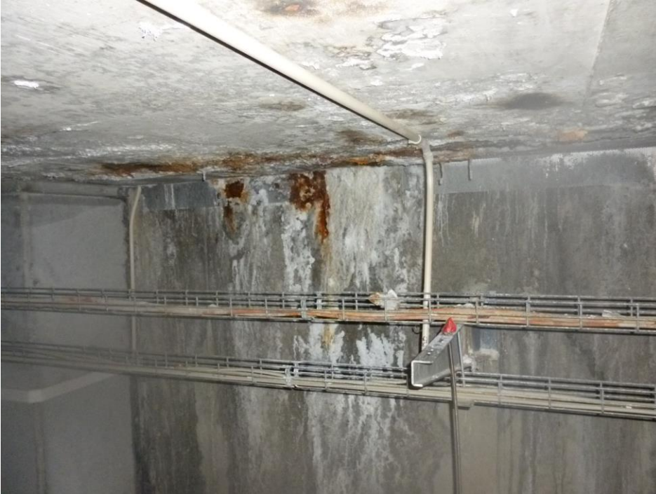
Billede 1. Kraftige rustudfældninger mellem væg og underside promenadedæk.
