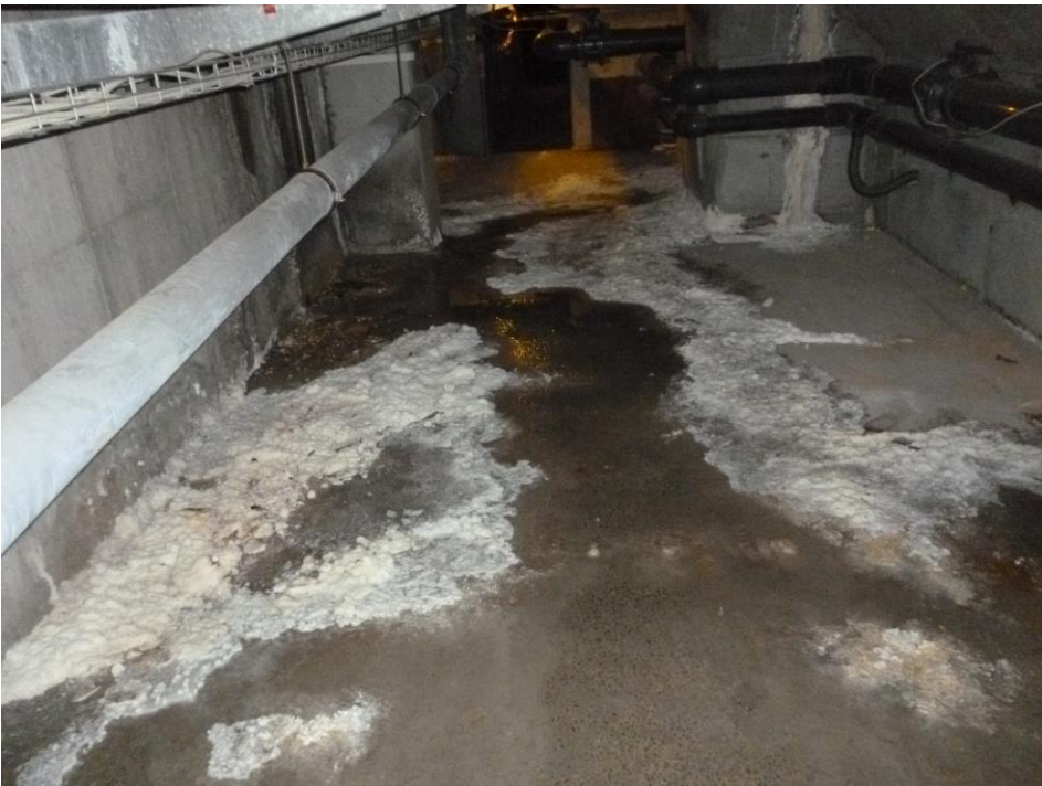
Billede 4. Saltudfældninger på klaplag i ingeniørgang fra inddampet bassin vand.
